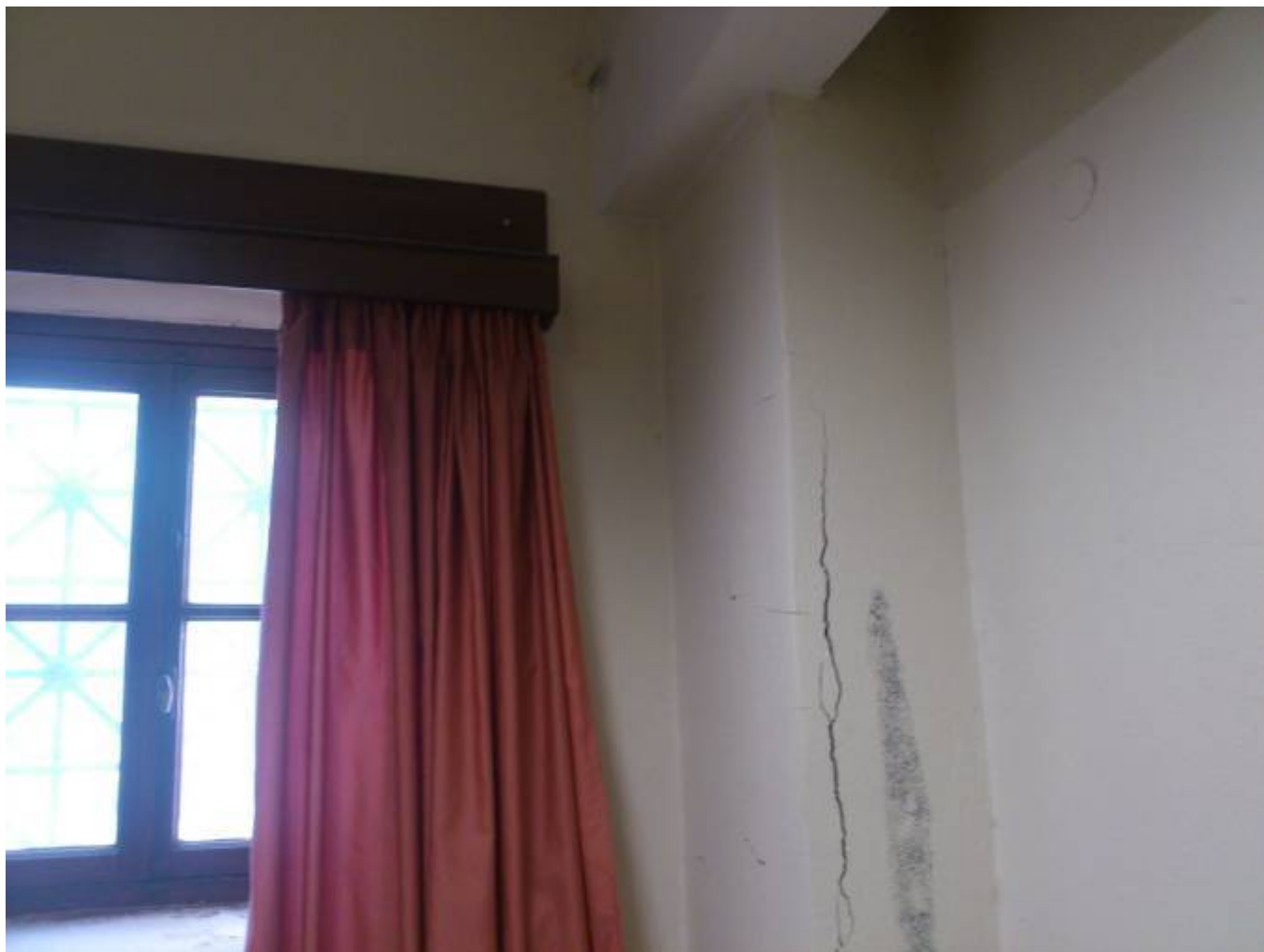
Εικόνα 7: Ρηγματωμένο επίχρυσμα στο υποστύλωμα – Αίθουσα 14 – Κτίριο Παλαιάς Φιλοσοφικής
