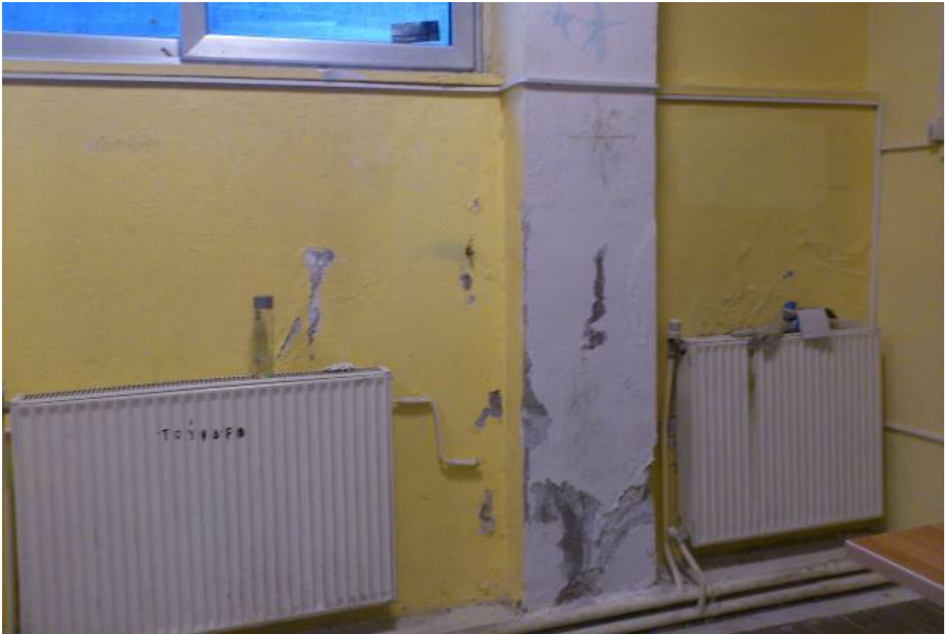
Εικόνα 9: Αποσαθρωμένο και ρηγματωμένο επίχρυσμα – Αμφιθέατρο υπογείου - Τμήμα Πολιτικών Μηχανικών
