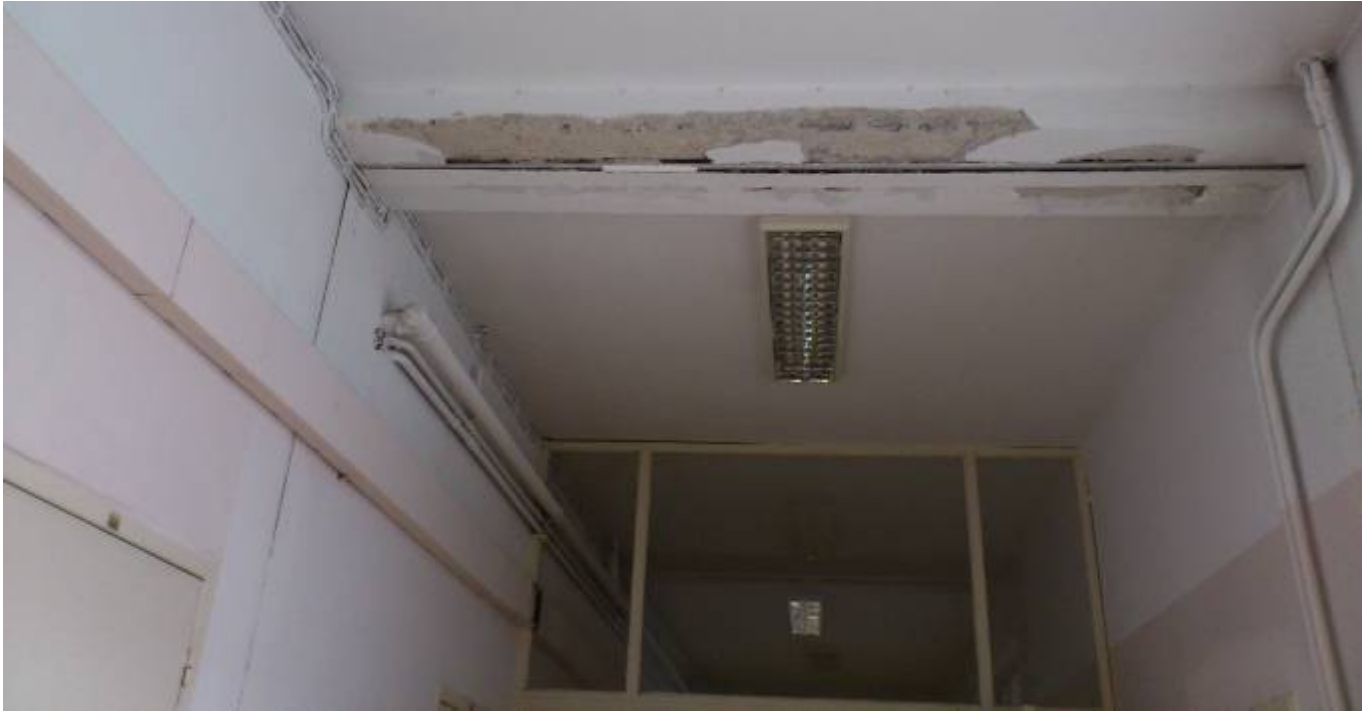
Εικόνα 12: Αποσαθρωμένο επίχρισμα στον αρμό – Διάδρομος 3 ου ορόφου παλαιού κτιρίου ΣΘΕ
