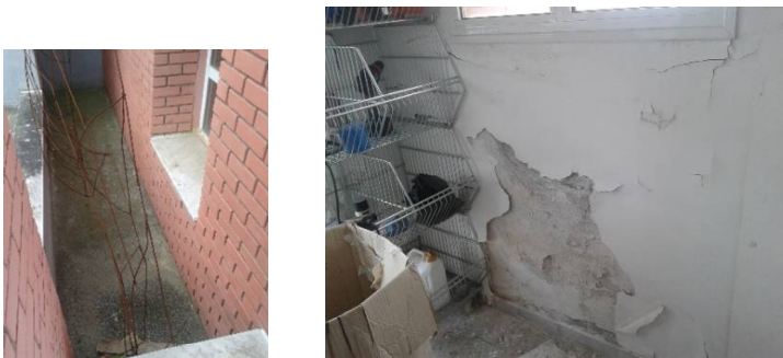
Εικ. 5 – Μη στεγανωμένη περιοχή με φραγμένο φρεάτιο (αριστ.), εμφάνιση υγρασίας και αποφλοίωση στον αντίστοιχο εσωτερικό τοίχο (δεξιά)
