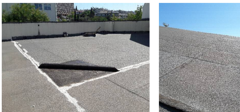
Εικ. 2 - Αποκολλημένα ασφαλτόπανα στο επίπεδο και στο κεκλιμένο δώμα
