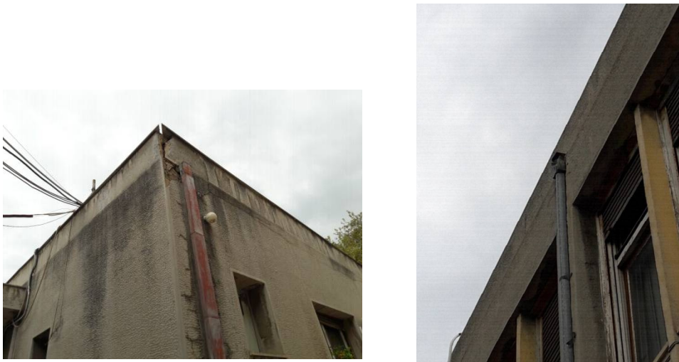
Εικ. 5 – Εκτενής ρηγμάτωση σε στηθαίο και κακή συναρμογή ταρατσομόλυβου και υδροροής
