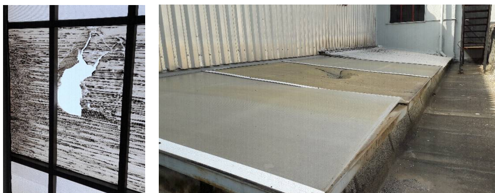
Εικ.4 – Οπή και κακή τοποθέτηση στο στέγαστρο από πολυκαρβονικά φύλλα
