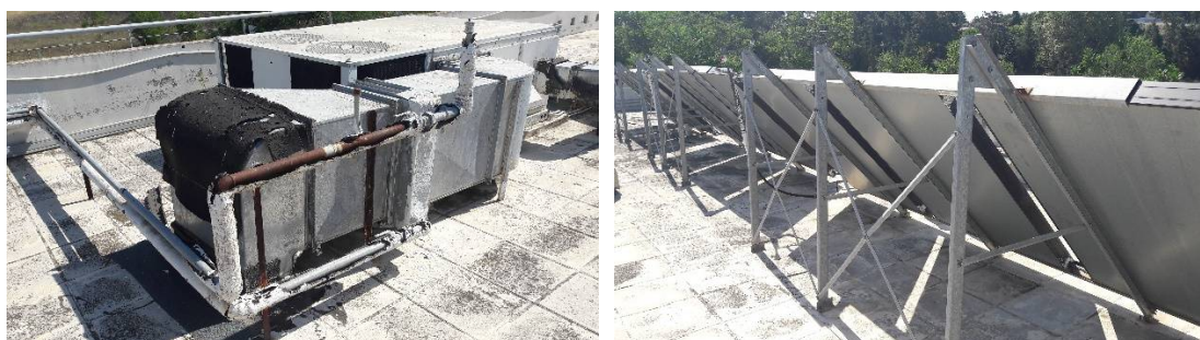
Εικ. 9 – Η/Μ εγκατάσταση (αριστερά), ηλιακοί θερμοσίφωνες (δεξιά)
