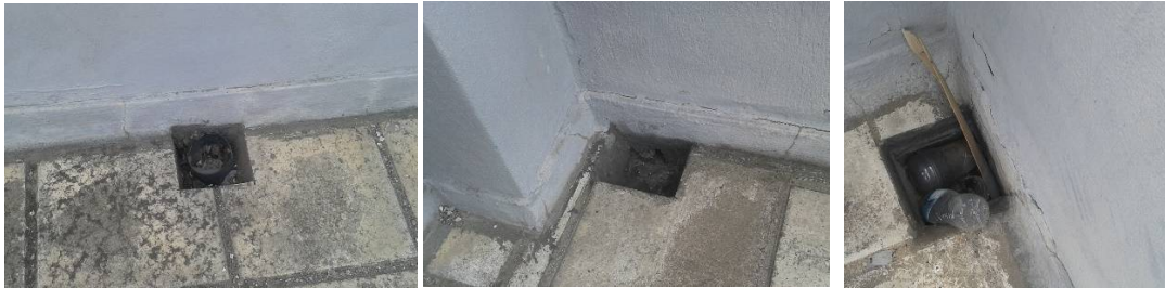
Εικ. 4 – Φραγμένα, μη στεγανωμένα φρεάτια υδροσυλλογής
