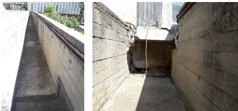
Εικ.2 – (α) Μη μονωμένο κανάλι υδροσυλλογής και (β) μη σφραγισμένος αρμός στο πέρας του καναλιού (σύνδεση με κτίριο ΝΟΠΕ)
