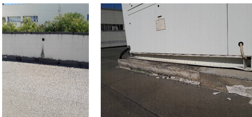
Εικ. 3 – (α) υγρασία σε στηθαίο από ανεπαρκές μήκος υδρορροής (β) αποσάθρωση επιχρισμάτων και βάση Η/Μ εγκαταστάσεων χωρίς μόνωση
