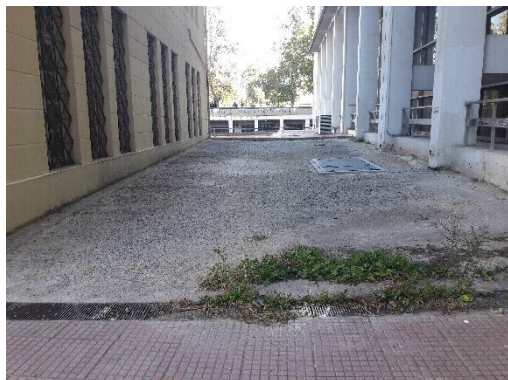
Εικ.4 – Αίθριο μεταξύ του κτιρίου της Νέας Φιλοσοφικής Σχολής και του Σχολείου της Νέας Ελληνικής Γλώσσας
