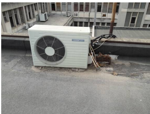
Εικ. 3 – Έδραση κλιματιστικού που τραυμάτισε την υφιστάμενη ασφαλτική στρώση
