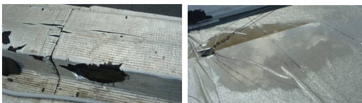
γ. φθαρμένο ασφαλτόπανο αρμού. δ. ασφαλτόπανο με πτυχώσεις και λιμνάζοντα ύδατα
