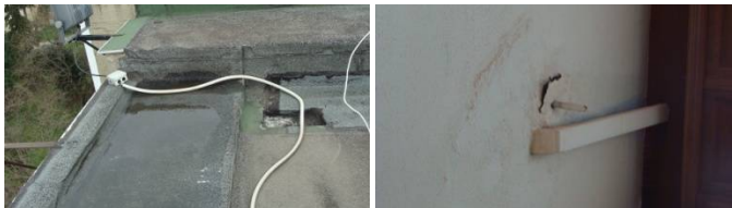
Εικ.4. Δώμα άνωθεν του Ιερού Ναού και υδρορροή εντός Ι.Ν.
