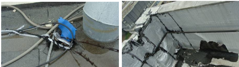
Εικ.2 - α. Αγκυρώσεις στο δώμα β. φθαρμένα ασφαλτόπανα στηθαίων
