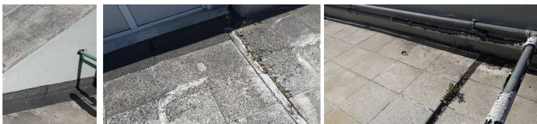
Εικ. 6 – Οπή στον φεγγίτη (αριστερά), μη σωστά στεγανοποιημένοι αρμοί δώματος (δεξιά)
