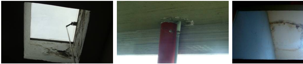
Εικ. 2 – Υγρασίες σε οροφή δώματος
