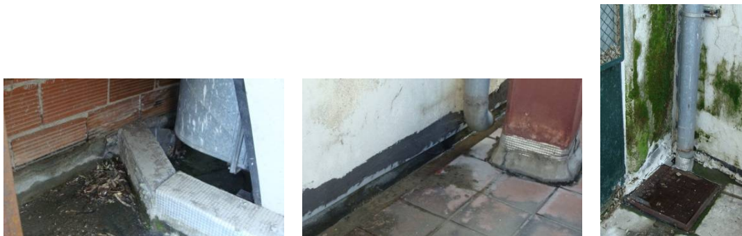
Εικ. 4 - Μη μονωμένο τμήμα δώματος και προβληματικές υδρορροές
