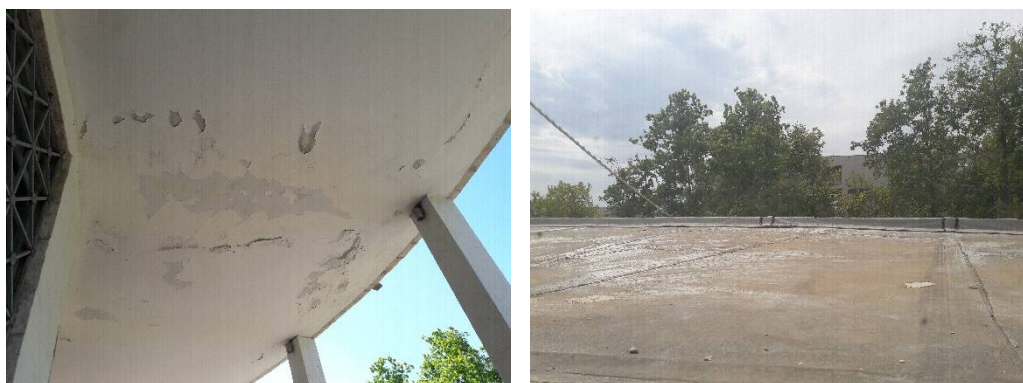
Εικ.1 – Τοπικές υγρασίες και παλαιά ασφαλτόπανα στο δώμα
