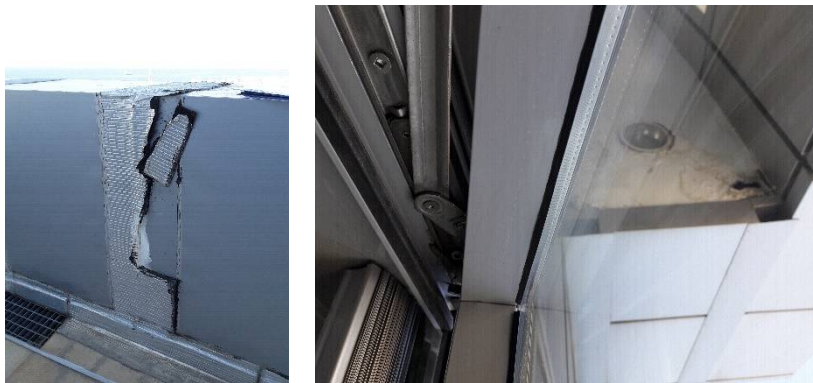
Εικ.1 – Αποκόλληση ασφαλτοπάνων και τοπικές διαρροές από κουφώματα
