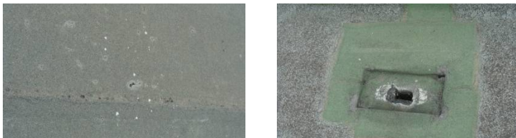
Εικ. 3. Φθαρμένα ασφαλτόπανα δώματος και ακάλυπτες υδρορροές
