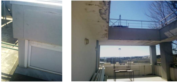
Εικ. 7 – Ρωγμή στην οροφή του φεγγίτη (αριστερά), ψευδοροφή δώματος με υγρασίες στην ανατολική πλευρά (δεξιά)
