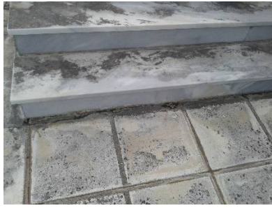
Εικ. 6 – Ρωγμές στη θέση έδρασης της σκάλας επί του δώματος
