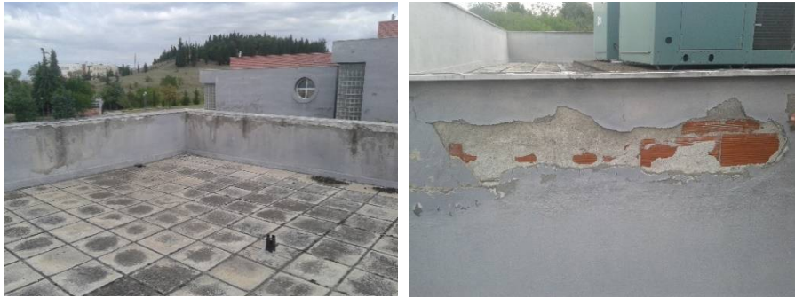
Εικ. 3 – Υγρασίες στα στηθαία περιμετρικά του δώματος
