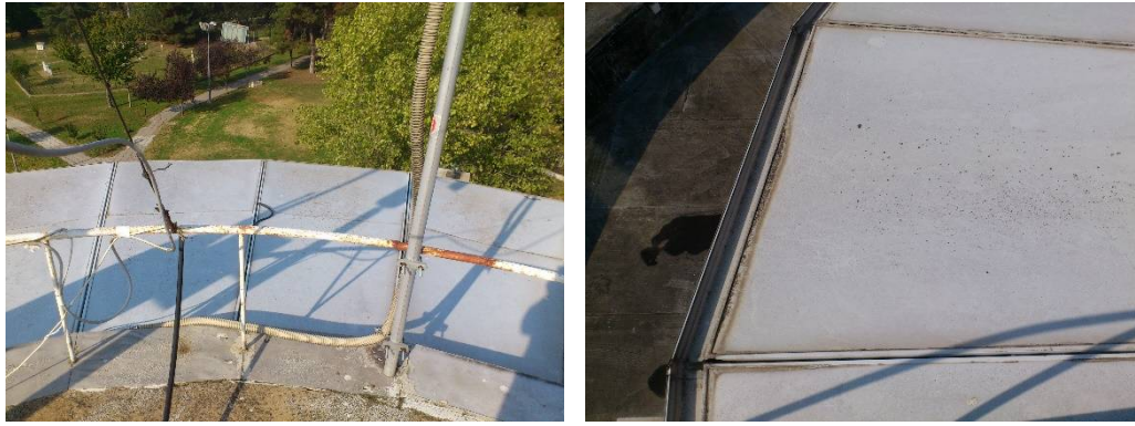
Εικ. 2 – Αμόνωτο δώμα τελικής στάθμης και μη σφραγισμένοι αρμοί αλουμινοκατασκευής
