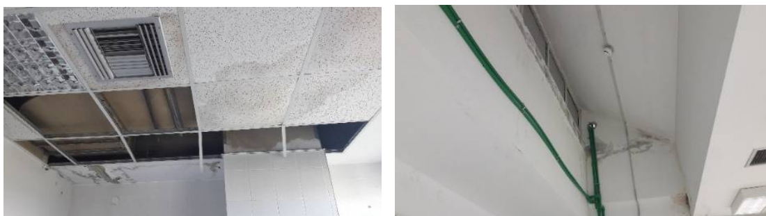
Εικ. 5 - Διαρροές από Η/Μ εγκαταστάσεις και οπές
