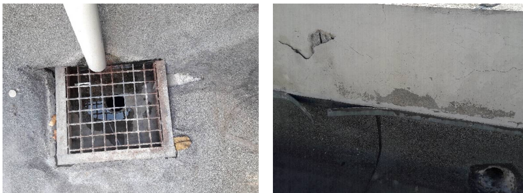
Εικ.3 – (α) Οπές στις ασφαλτικές μεμβράνες, (β) αποξηλωμένες στηρίξεις και αποκάλυψη οπλισμών στα στηθαία του δώματος
