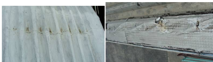
Εικ. 2 - Ρωγμές στο ασφαλτόπανο της στέψης και αστοχίες στο περιμετρικό ασφαλτόπανο του στηθαίου της στέγης.
