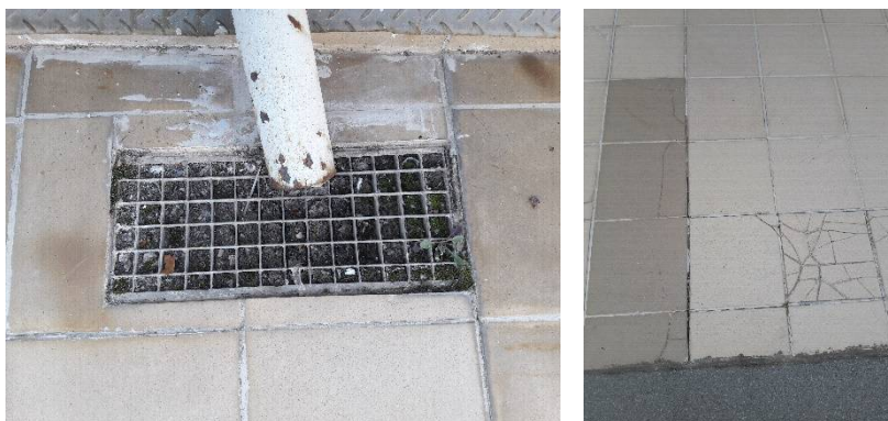
Εικ.4 – (α) φραγμένο φρεάτιο υδροσυλλογής, (β) ρηγματωμένα πλακίδια και αρμοί πλακιδίων
