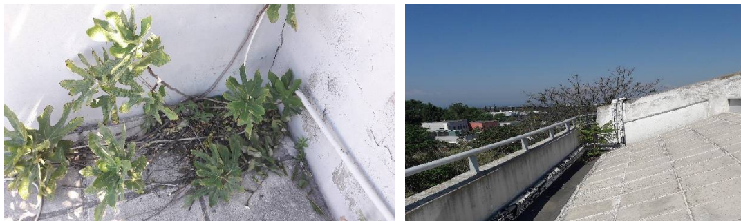
Εικ. 11 – Φραγμένα φρεάτια υδρορροών
