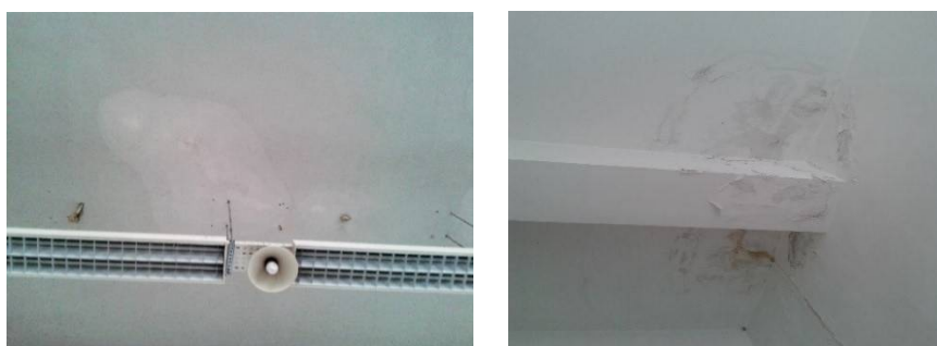
Εικ. 2 – Υγρασίες σε εσωτερικούς χώρους
