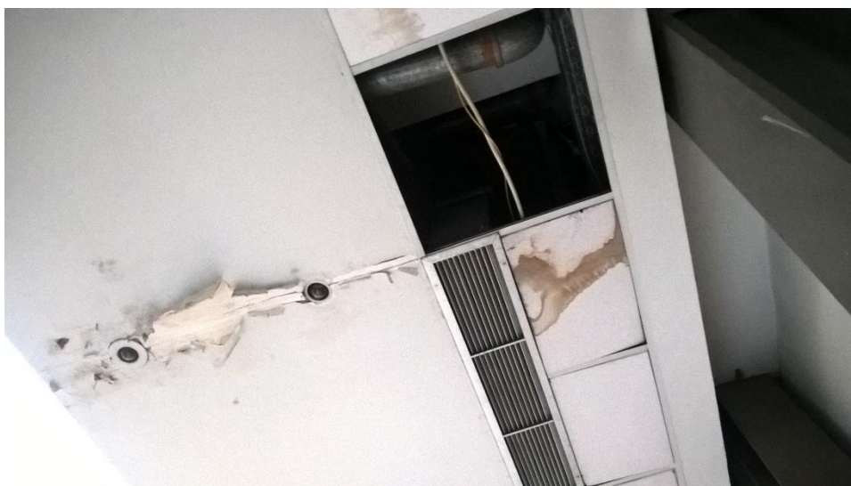
Εικόνα 7,8,9 – Φωτισμός και φθορές στην είσοδο των αμφιθεάτρων
