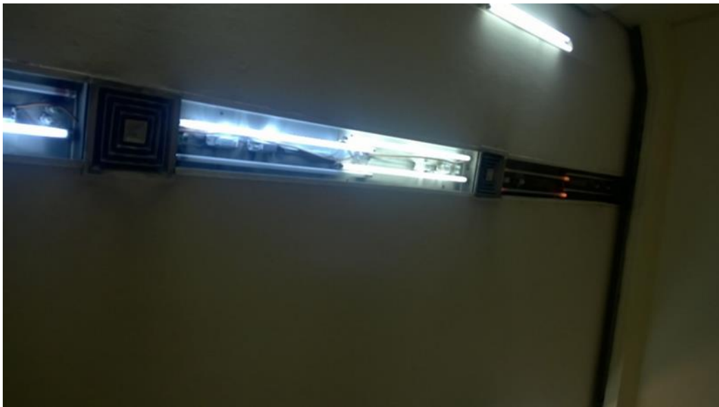
Εικόνα 2 – Φωτιστικά σώματα εγκατεστημένα στην οροφή
