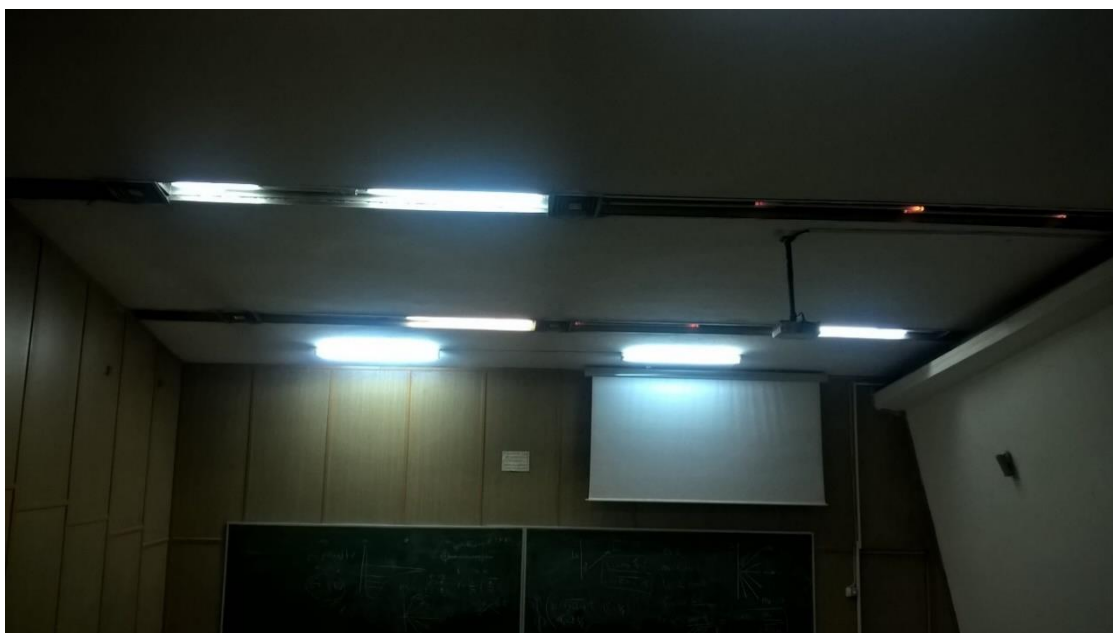
Εικόνα 1 – Γενικός φωτισμός αμφιθεάτρου
