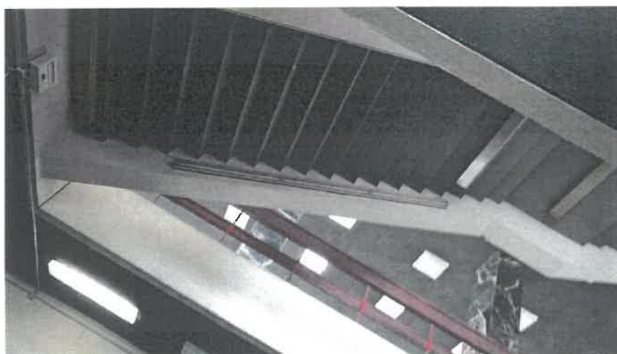
Εικόνα 3 – Φωτιστικά εγκατεστημένα στο κλιμακοστάσιο
