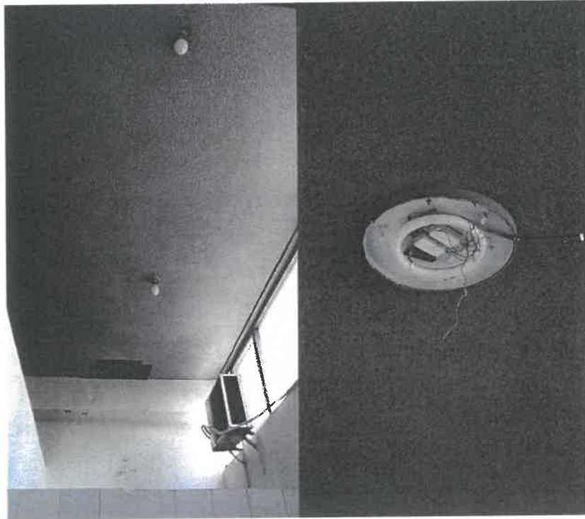
Εικόνα 4 και 5- Φωτισμός WC
