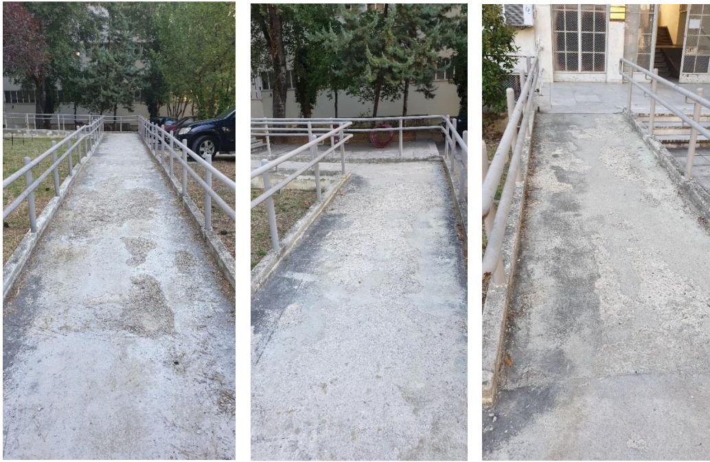
Εικόνα 2 - Υφιστάμενη κατάσταση ράμπας ΑμεΑ στον αύλειο χώρο του κτιρίου Ιατρικής
