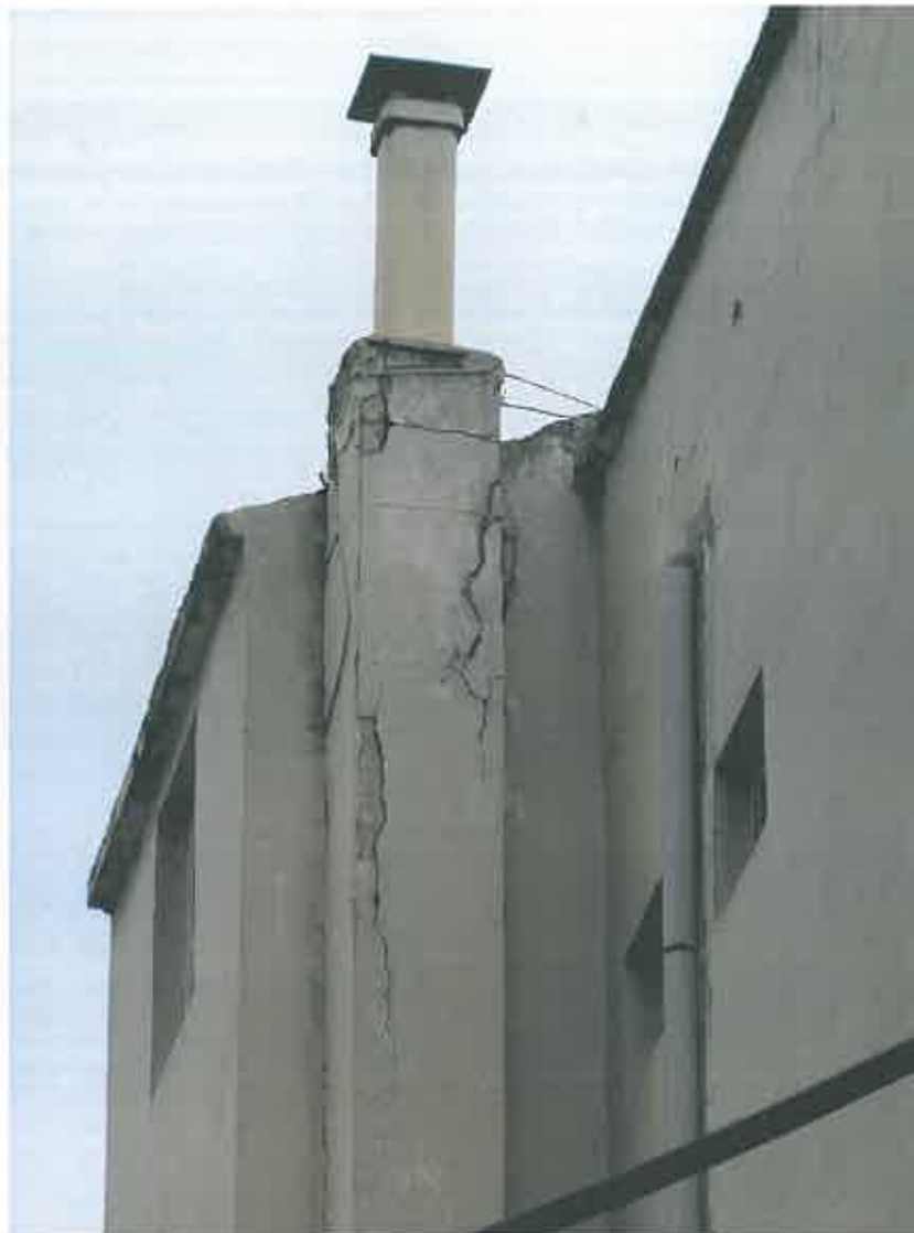
Εικόνα 4. Ρηγματώση στη στέψη της καπνοδόχου
