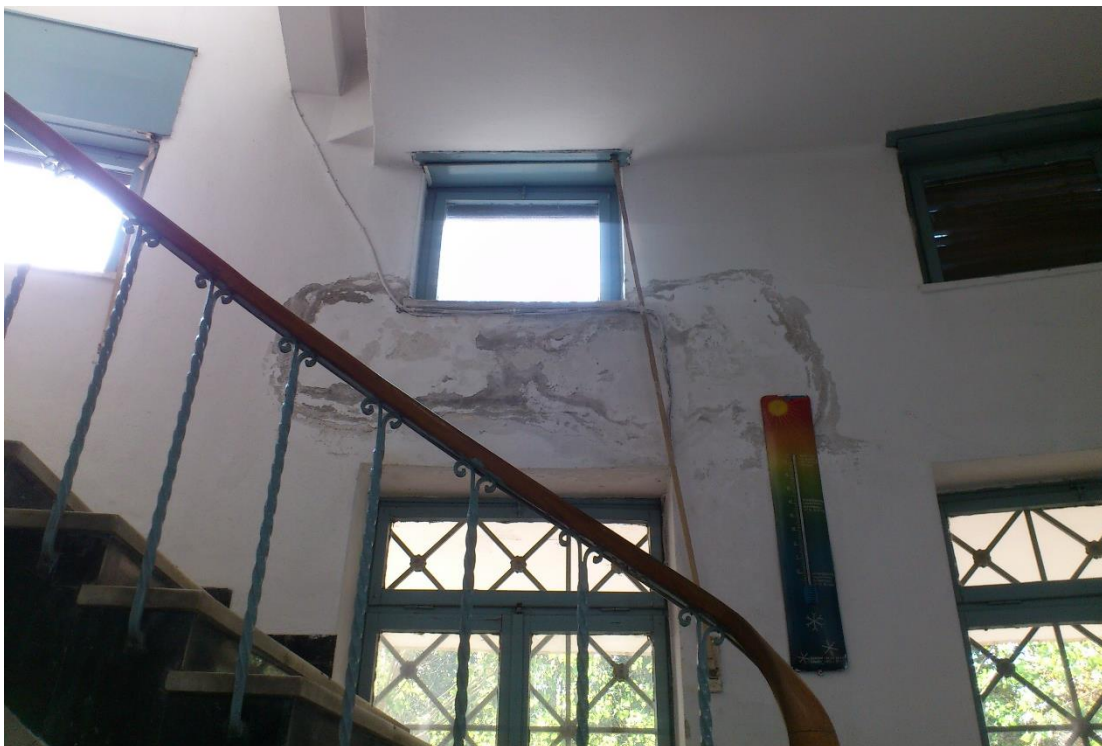
Εικόνα 3 - Άποψη αποσαθρωμένων επιχρισμάτων και παλαιών κουφωμάτων στο κλιμακοστάσιο
