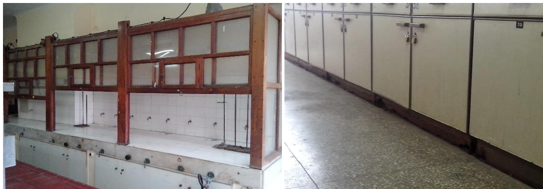
Εικόνα 13 - Παλαιό σύστημα απαγωγού επικίνδυνων πτητικών ουσιών που δεν πληρούν τις υπάρχουσες προδιαγραφές (αριστερά) - Εργαστηριακοί πάγκοι σε κατάσταση προχωρημένης διάβρωσης (δεξιά)
