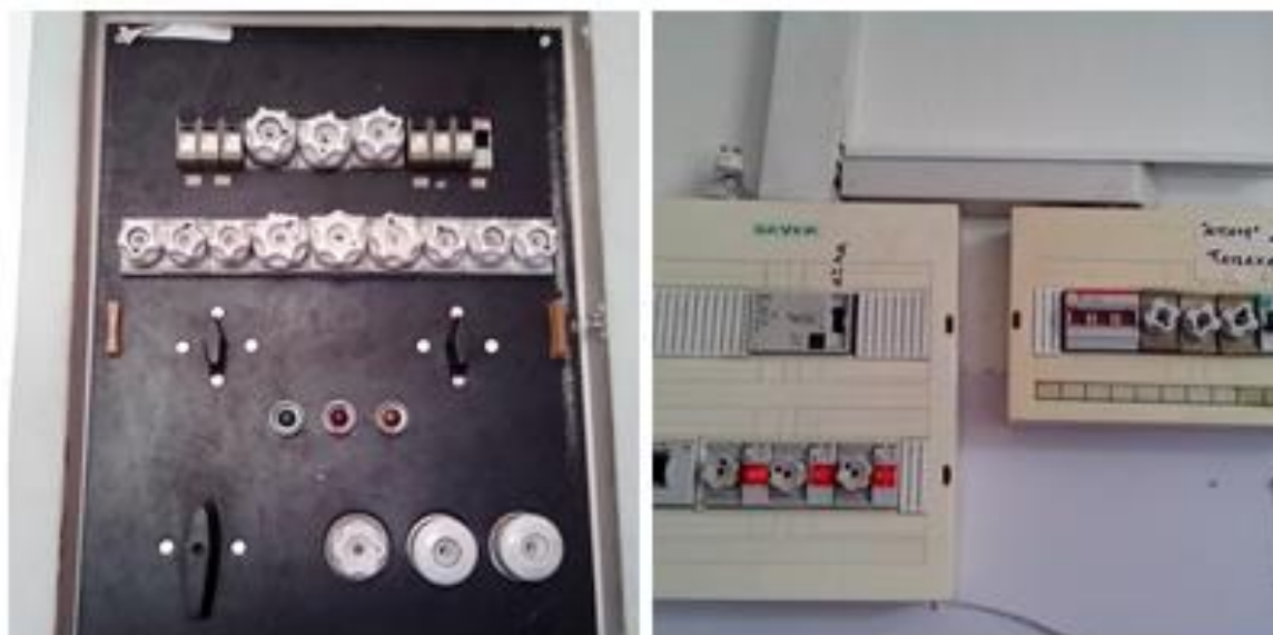
Εικόνα 4 - Πίνακας διανομής κτιρίου - Υποπίνακες
