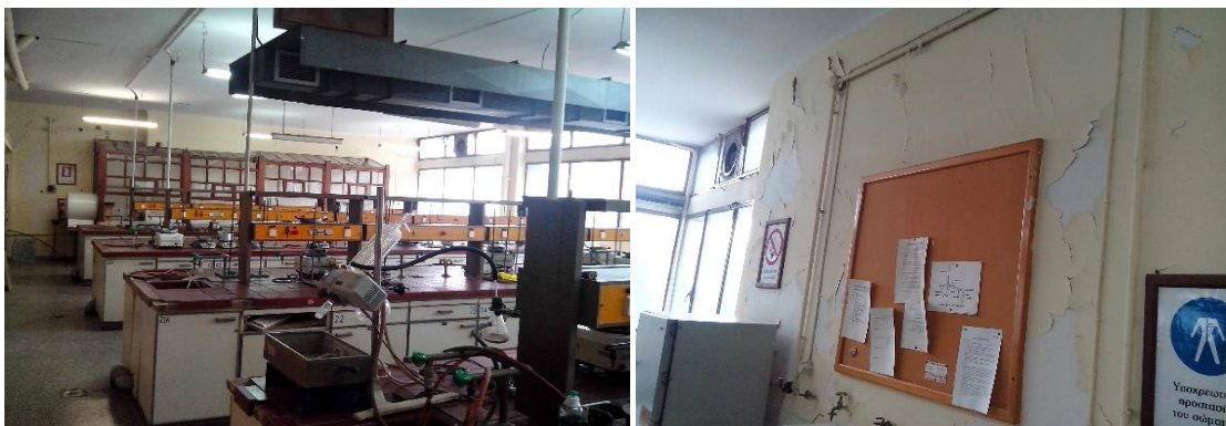
Εικόνα 10 - Ελλιπής φωτισμός με φωτιστικά παλαιάς τεχνολογίας (αριστερά) - Κατεστραμμένος χρωματισμός τοίχων (δεξιά)
