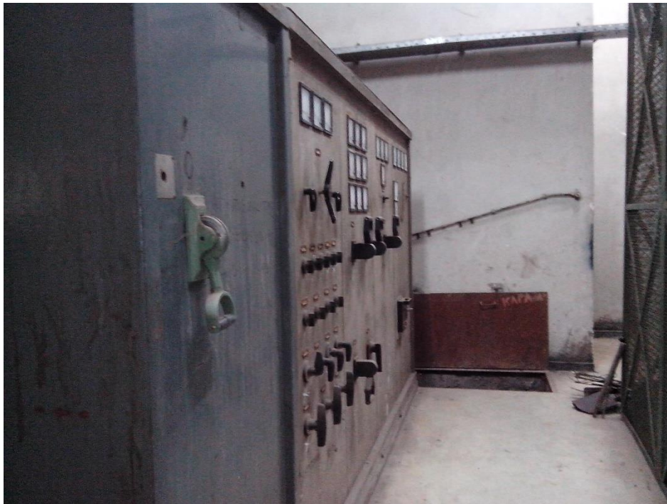
Εικόνα 7 - Πεδία χαμηλής τάσης
