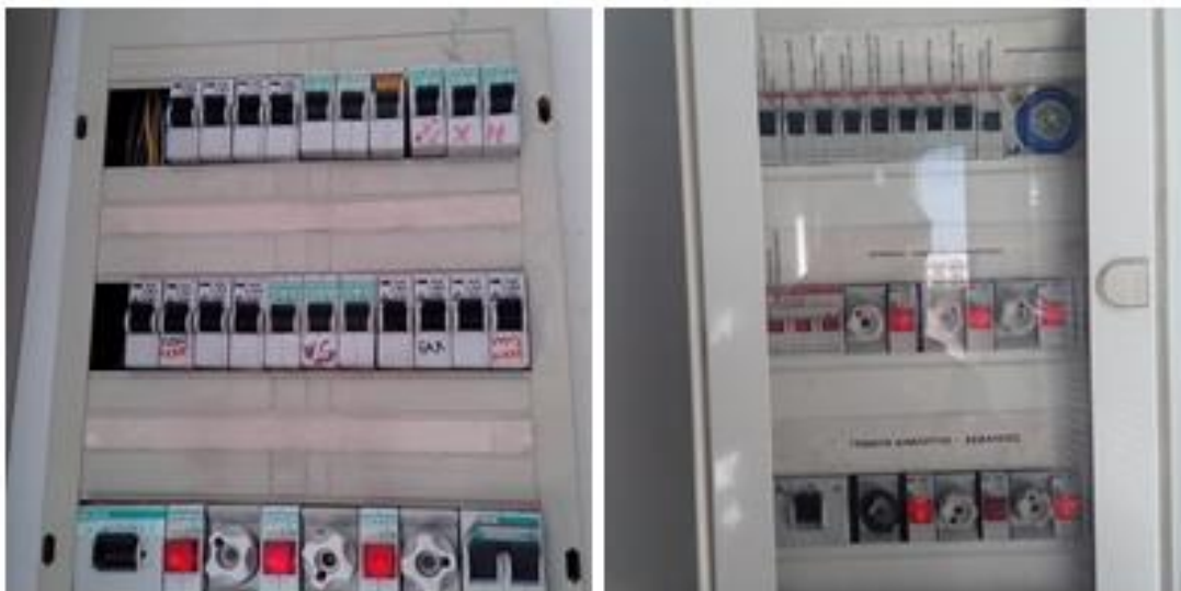
Εικόνα 6 - Πίνακες ορόφου και δώματος
